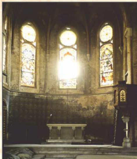
Der teilweise beräumte Altarplatz mit beschädigtem Mittelfenster und Wasserschäden
